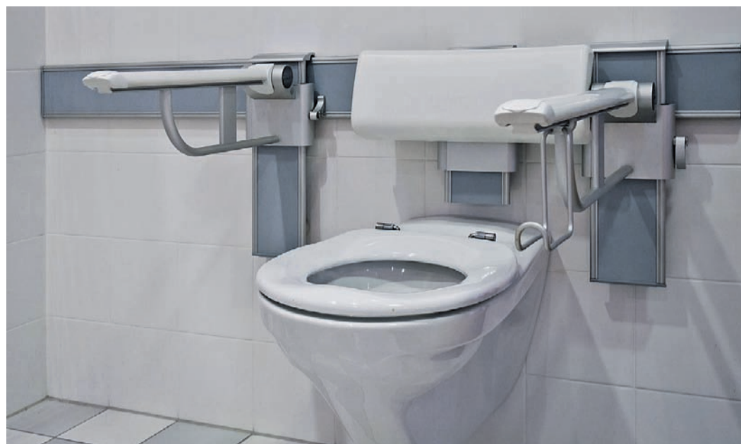
Beim barrierefreien Umbau des Bades sollte man auf eine Ausstattung der Toilette mit hochklappbaren Stützgriffen achten. Foto: modul_a/Fotolia
